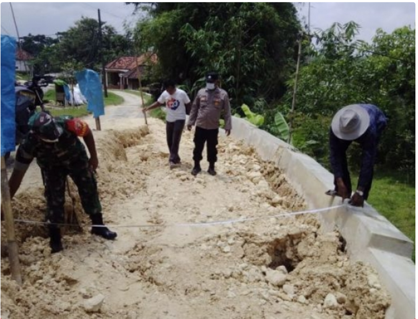
Babinsa Koramil 0829/15 saat mengukur jalan Desa yang ambles
